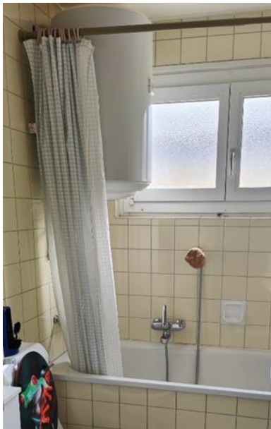
Image 13 : salle de bain non rénovée
